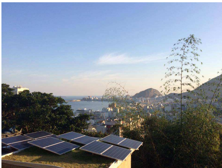
Figura 5.4 – Projeto piloto fotovoltaico Estrelas de Babilônia (3 kWp)
